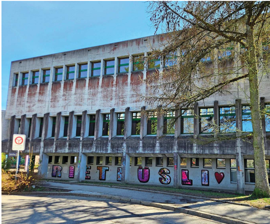
Die Einfachturnhalle Riethüsli wurde 1981 gebaut. Mittlerweile ist sie sanierungsbedürftig.
